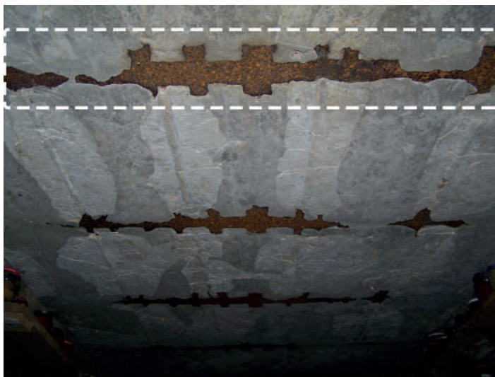
Il. 165 Ogniwa od niemieckiego czołgu Tygrys II wykorzystane do wzmocnienia stropu w piwnicy, Lisów 2015 r.
